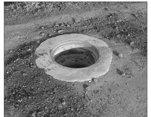
Csak a szerencsén múlt, hogy korán hajnalban senki nem hajtott bele az út közepén tátongó, “fedelét vesztett” csatornanyílásba.
